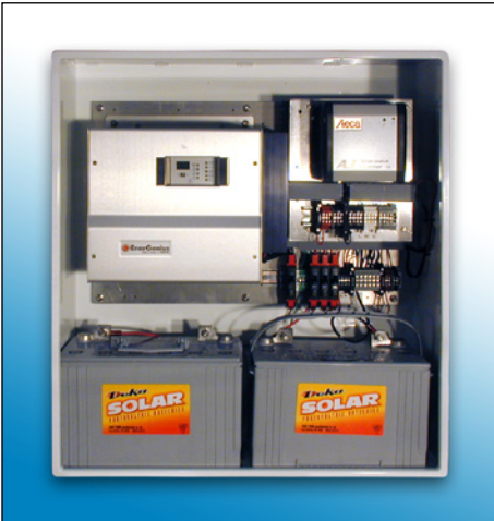
Sistema de Energía en Línea con baterías 108AH GEL de 24Vdc, inversor AC optativo y convertidor DC:DC
