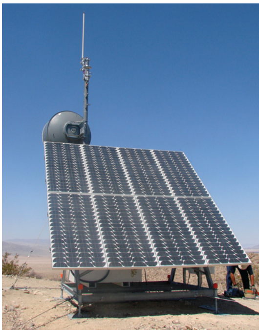
Esta estación SunWize de 1200 Watts en una localidad remota alimenta equipo de telemetría.
