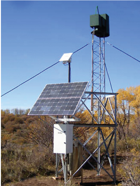
Este sistema PowerReady PR230 localizado en Wyoming alimenta equipo de modificación ambiental (siembra de nubes)
