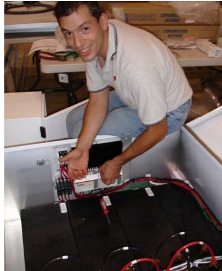
Caja de control de una Estación de Potencia de SunWize con ocho baterías de ciclo profundo y de esponjas de absorción de fibra de vidrio.
