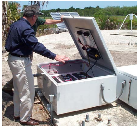
Este Sistema Power Ready de SoListo da energía a equipo de detección de rayos en el Centro Espacial Kennedy de la NASA. El arreglo FV genera electricidad DC que se almacena en banco de baterías. Un inversor cambia la electricidad DC de las baterías a corriente AC de calidad similar a la de la red para operar las cargas.
