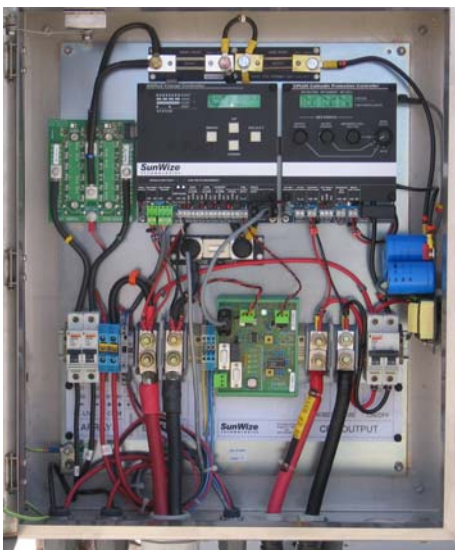
Interior de una caja de control de una Estación de Potencia que muestra los controladores de recarga y protección catódica de fácil reparación en el campo.
