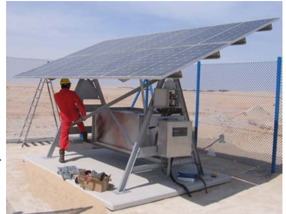
Estación de Potencia de 1920 watts para protección catódica de pozos en ambientes desolados. El sistema integrado está colocado en una plataforma de concreto.
