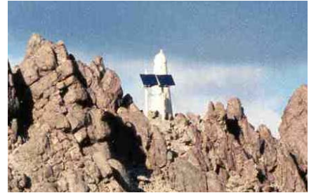
Sistema FV instalado en el Parque Nacional Volcán Lassen, CA, a 3,200 m.
