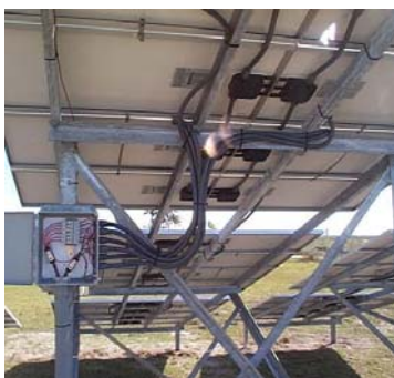
Parte posterior del arreglo solar y caja de conexiones.
