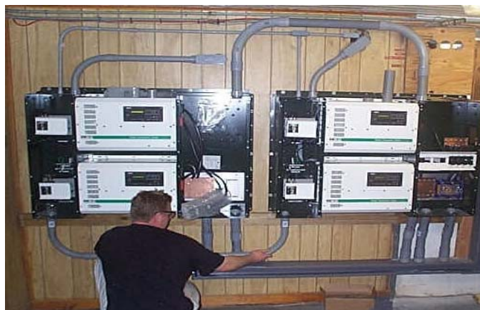
Doble Centro de Potencia con Inversor/Recargador Xantrex SW4048.
