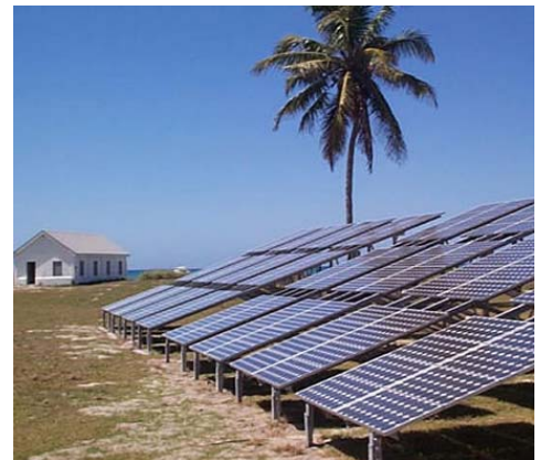
Este sistema en el Parque Nacional Dry Tortugas ha soportado huracanes y años de rocío de agua marina y continúa dando energía para agua potable y viviendas.
