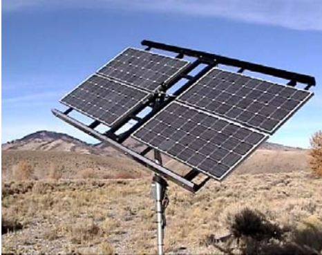
Incesantemente sujeto a temperaturas extremas, este sistema FV produce energía para un sistema de bombeo de agua en el desierto.
