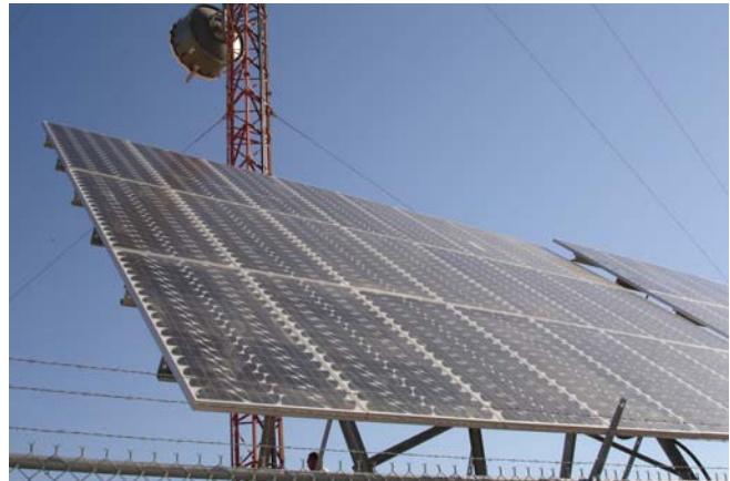
Una Estación de Potencia SunWize® de 7680 watts con generador de gas LP para dos radios BTS, radio de microondas y unidad de aire acondicionado.
